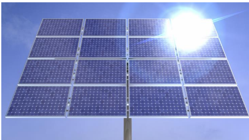
Рисунок 5 – Солнечная фотоэлектрическая установка
